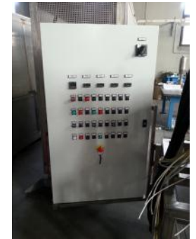
Quadro elettrico di controllo e comando
